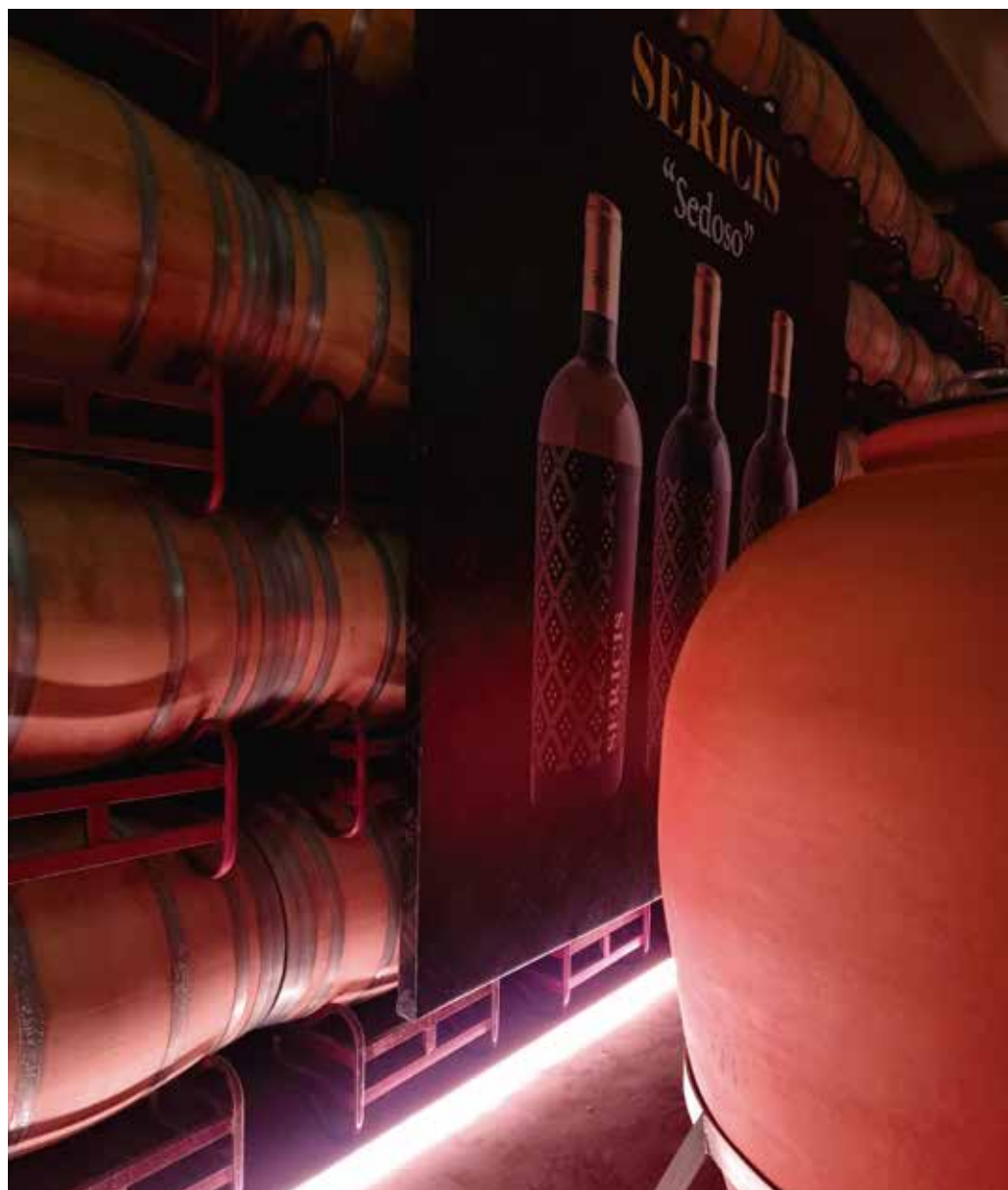
Tira led RGB 220V 16W "Aθο"+Controlador "AL03" en Bodegas Murviedro / Grupo Sindel
